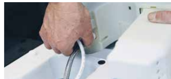
Les branchements électriques et d'eau se trouvent dissimulés à l'intérieur de la cuvette de WC.
